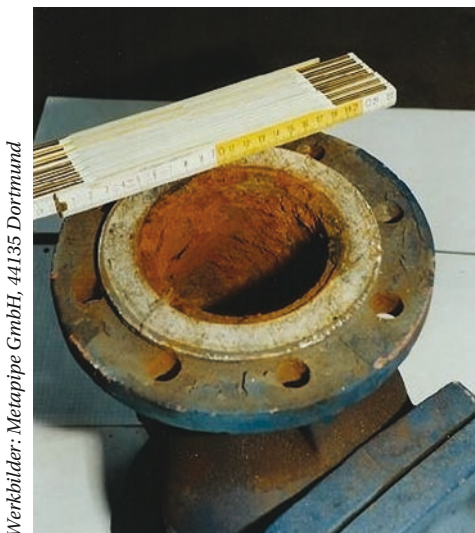
Graugussventil aus einer Kompressorenstation mit deutlichen Korrosionsablagern
