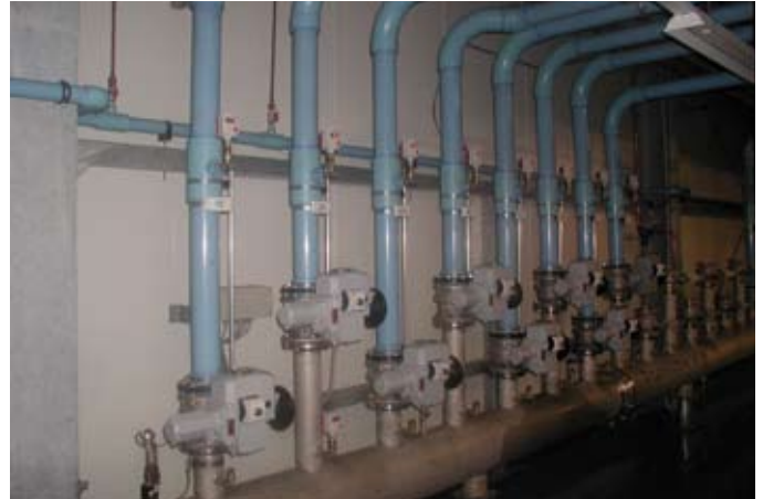
Blick auf eine moderne Druckluftverteilung
